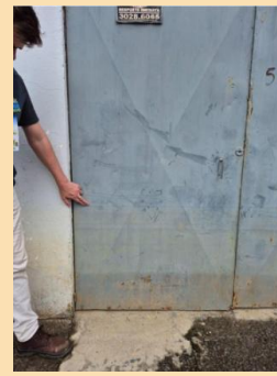
Marcas deixadas pelas águas durante a grande inundação de maio de 2024. Setor de risco 70/01.
