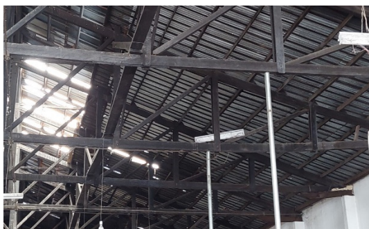
Imagem 20 – Flambagem das tesouras.
