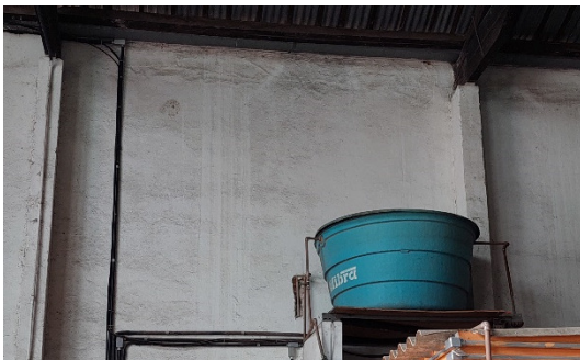
Imagem 33 – Vazamentos das calhas sobre o escritório do prédio.
