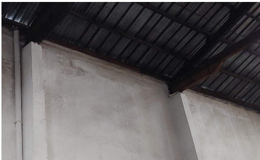
Imagem 3 – Fissura entre a viga e a alvenaria.
