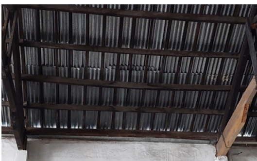
Imagem 18 – Flambagem do elemento terça.
