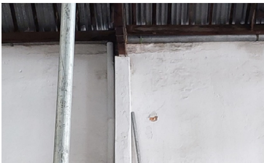
Imagem 8 – Deslocamento do reboco.
