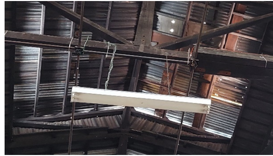
Imagem 35 – Luminárias sem lâmpadas.
