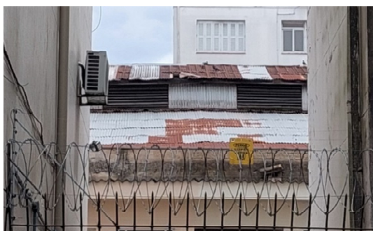
Imagem 24 – Telhas soltas, enferrujadas e danificadas.
