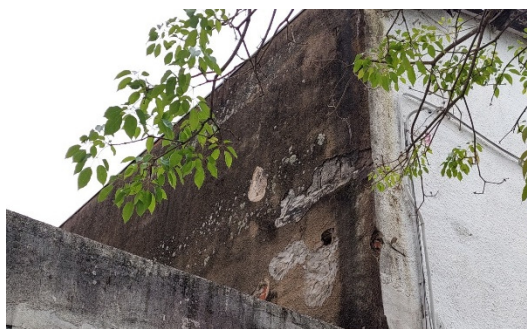
Imagem 13 – Reboco externo danificado.
