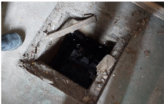
Imagem 31 – Falta de manutenção e obstrução das caixas coletoras de esgoto.
