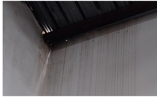
Imagem 30 – Vazamento nas calhas.
