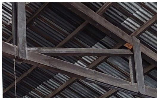
Imagem 21 – Peça de travamento solta.
