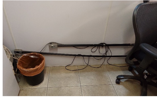
Imagem 42 – Eletrodutos sem fixação.
