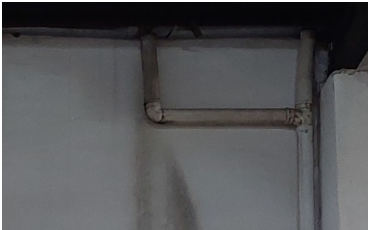
Imagem 29 – Vazamento nos tubos de queda das calhas.
