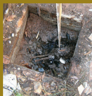
Caixa adicional de calçada com raízes de árvores
