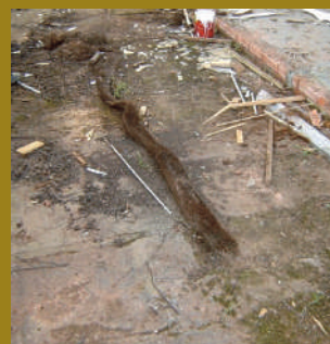
Raiz retirada da tubulação
