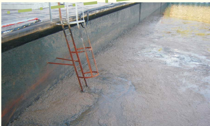
Figura 3: Lodo gerado no processo de tratamento de água nas unidades de decantação da ETA José Loureiro da Silva.
