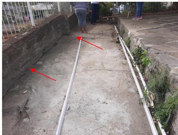
Figura 2-2: Trinca na região da crista
