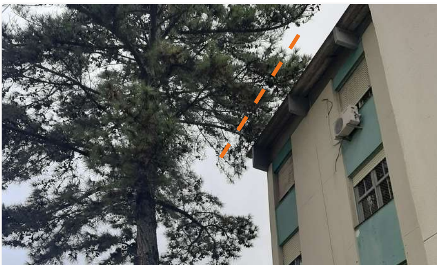
Figura 09: Afastamento do telhado.
